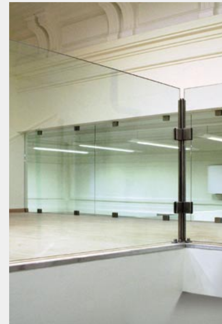
Перегородки установлены не на полную высоту проема
